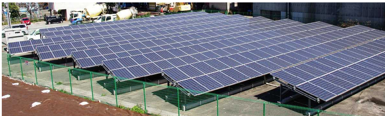
川崎市の一角で見た太陽光発電所
