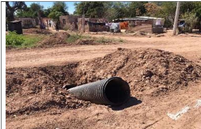
放置されたままの下水道工事
