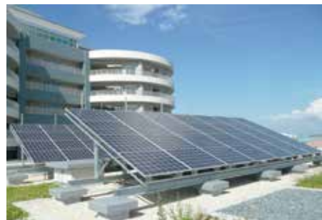
▼病院や学校に設置されている10kW型太陽光パネル。中山の提案はこの470台分のCO2削減を実現したことになる
