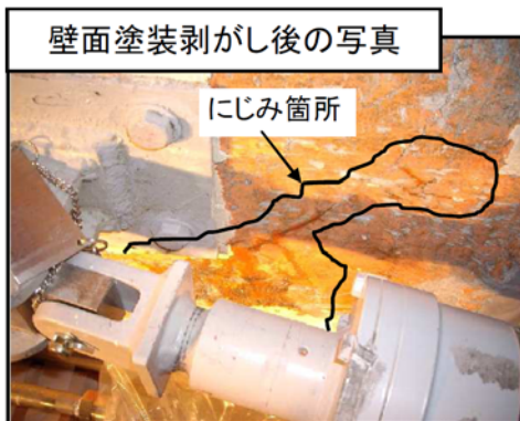
①部 壁からのにじみ箇所 （2007年6月14日付関電報道発表より）
