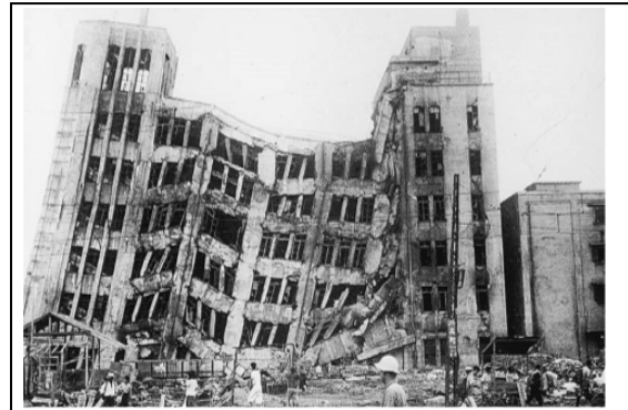
図9 損壊した大和百貨店(福井市)。1階が壊れ、各階の梁が著しく破壊し、また火災による被害も受けた。小林啓美氏(東京工業大学名誉教授)撮影・提供 日本地震学会広報紙「なるふる」より
