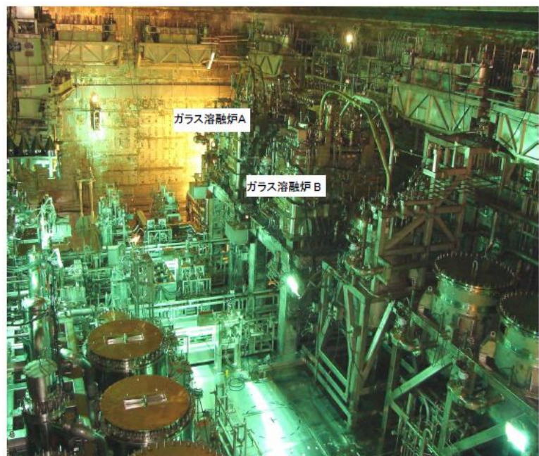
固化セル内：漏えいした放射性廃液はガラス溶融炉Aの後部上方付近から降り注いだと考えられる。
