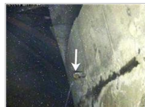
東京電力福島第1原発1号機の格納容器下部で、破断し水漏れが確認された配管(矢印) = 13日(東京電力提供)
