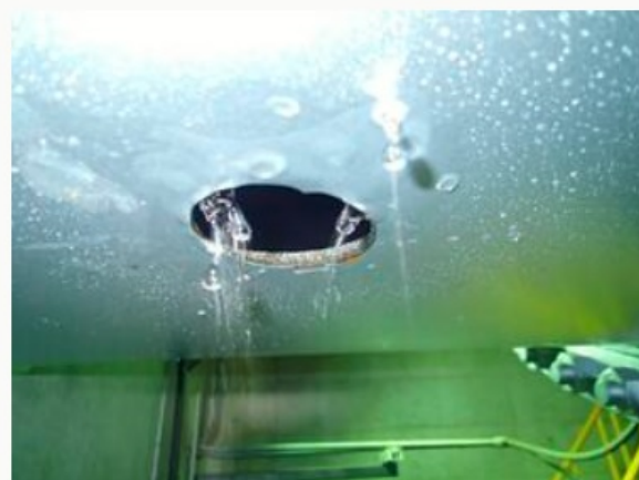
東京電力柏崎刈羽原発7号機で、蒸気を水に戻した海水が流れる配管で見つかった直径6センチの穴（東京電力提供）
