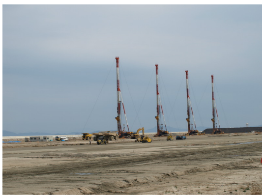
埋め立てが進む岩国新基地。地盤の補強のため、この塔から砂を注入して補強をしているという。かつては、藻場がある豊かな海だった。
