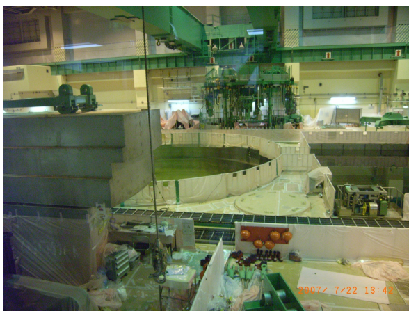
6号機原子炉上部のクレーンが破損
