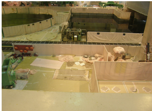
放射能を含む使用済み燃料プールの水漏れ
