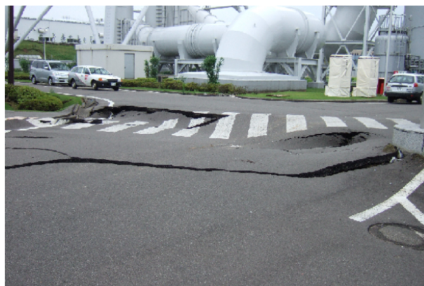
敷地内道路は各所でズタズタ
