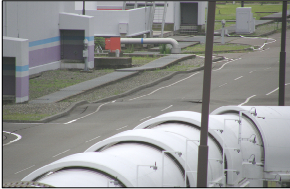
波打つ敷地内道路
