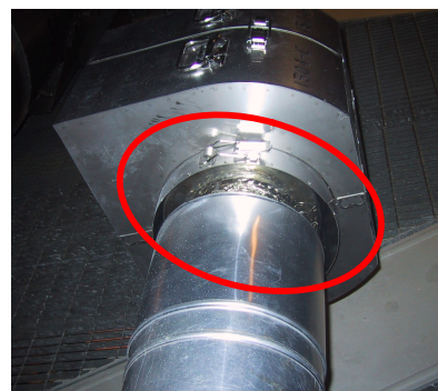
原子炉内建屋内配管のズレ
