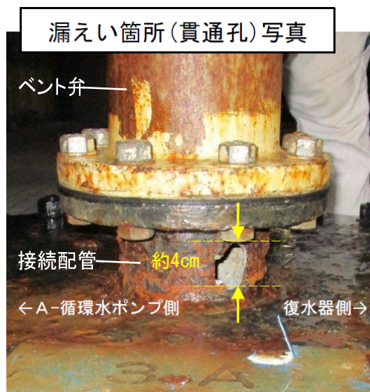
大飯発電所3号機の出力降下について（2021.8.10関電）より
