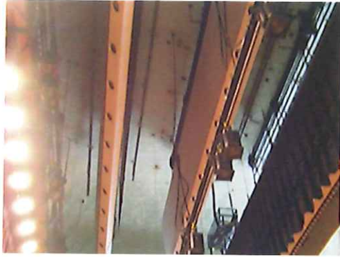
第1ホール吊物機構・照明バトン
