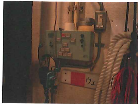
第1ホール連絡設備（インカム）
