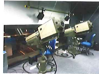
(右・ピンスポット室の事例写真；いわき芸術交流館アリオス)
