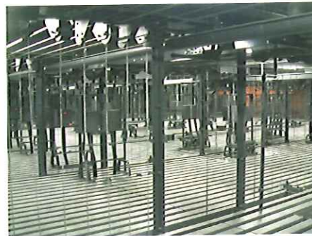
事例写真：舞台上部すのこ (いずれも兵庫県立芸術文化センター)
