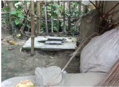
壊れたトイレ
