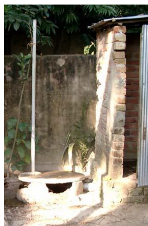
写真-6(3) 穴があけられた Pit Latrine
