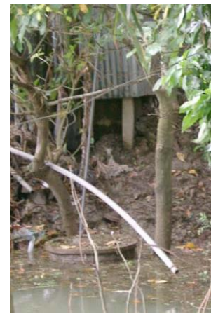
写真-6(4) 雨期に水没する Pit Latrine
