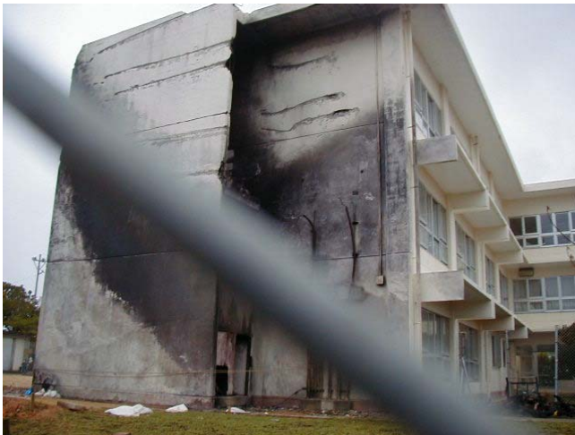
沖縄国際大学1号館の焼け跡(2004年9月撮影)
